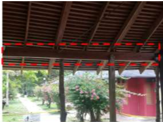
VIGA A REMPLAZAR
